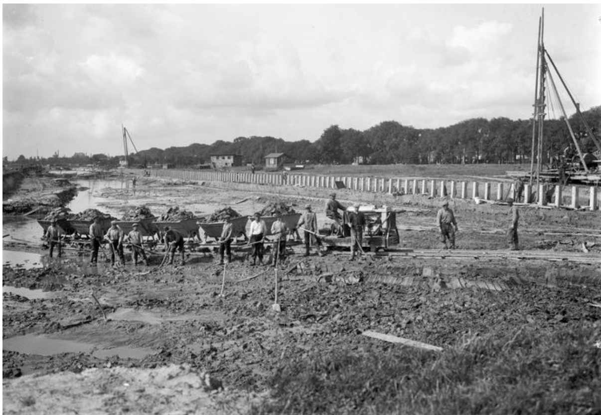
Graafwerk voor de aanleg van de Veilinghaven, die is uitgegraven door handwerk en met scheppen. De aarde werd afgevoerd in kiepkarretjes op tijdelijk aangelegde rails. Foto uit 1927. © Het Utrechts Archief
