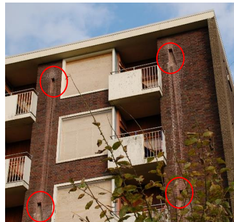
Figuur 3. Met onvoldoende ventilatie blijven vleermuisverblijfplaatsen aanwezig de gebouwen niet ongeschikt maken spouwmuur door het openbreken van de buitenmuur.
