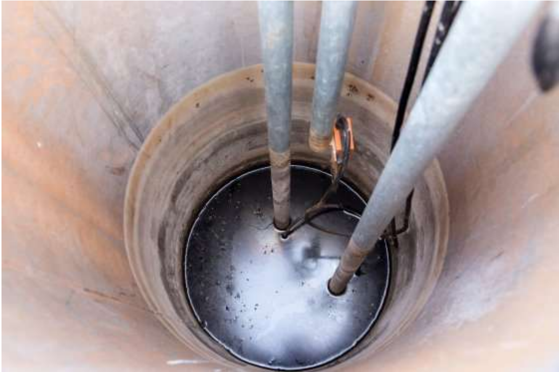
• Detailfoto van de binnenkant van de waterpomp; buizen waarmee het water wordt aan- en afgevoerd.
