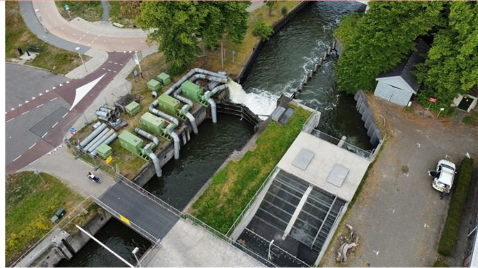
Gemaal 'de Aanvoerder' in met noodpompen bij het ARK in Utrecht
