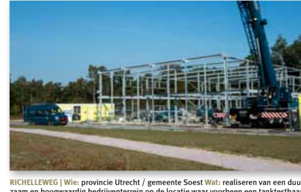
RICHELLEWEG | Wie: provincie Utrecht / gemeente Soest Wat: realiseren van een duurzaam en hoogwaardig bedrijventerrein op de locatie waar voorheen een tanktestbaan van Defensie was. Status: in uitvoering / kavels in verkoop. Het bedrijventerrein is bouwrijp (eerste fase), eind 2013 is het eerste pand gereed. Planning: de komende jaren worden de kavels uitgegeven. Afhankelijk van het uitgifte tempo wordt de tweede fase bouwrijp gemaakt.
