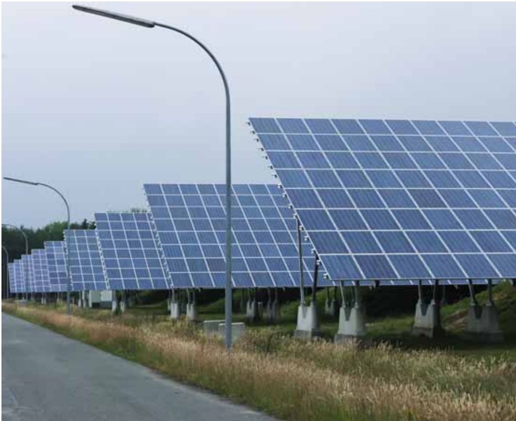
Duurzame energie goed ingepast
